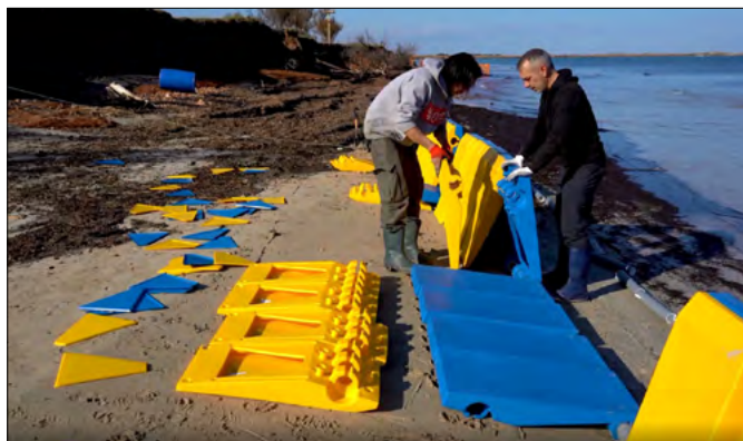
FIGURA 4. Fase di installazione dei moduli del Sistema Modulare Antierosione parallelamente alla costa, con il lato aperto verso la spiaggia.
