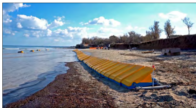
FIGURA 1. Sperimentazione del Sistema Modulare Antierosione lungo un tratto dell'arenile della "Riserva di Torre Guaceto" di Carovigno (BR).
